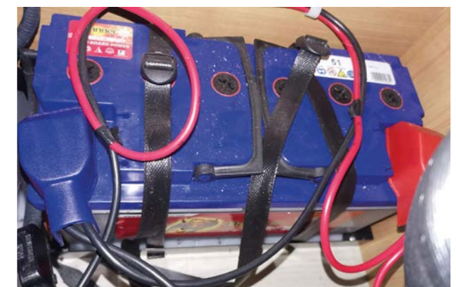
AVANT : batterie plomb installée
