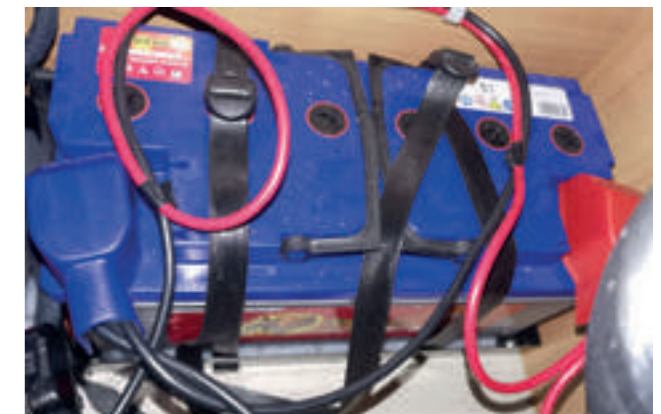
AVANT : batterie plomb installée
